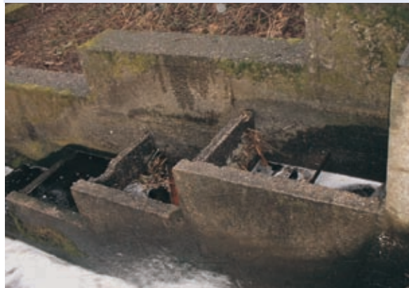
Abb. 9.3: Alter Beckenpass, der wegen zu kleiner Dimensionierung nicht passierbar ist
