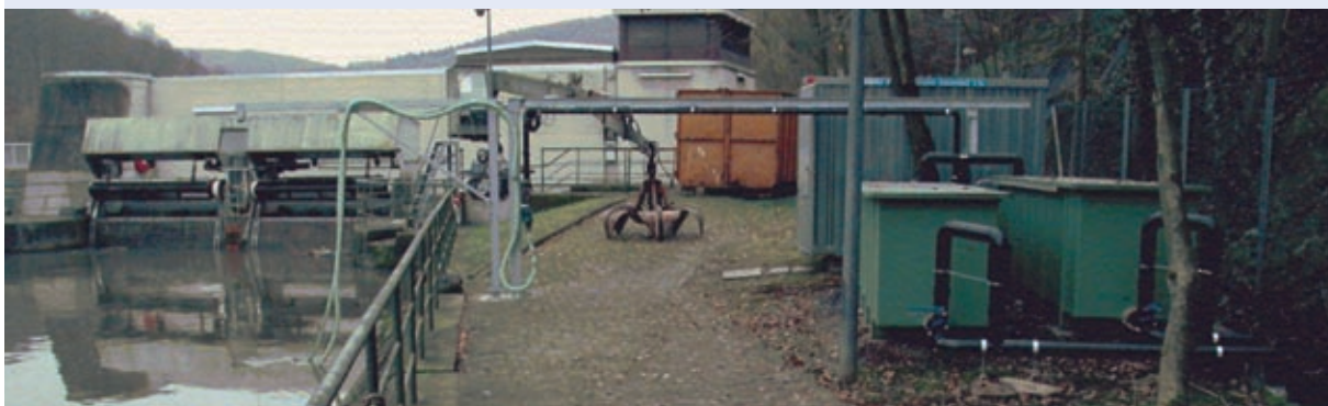
Abb. 12.37: Das Frühwarnsystem MIGROMAT® wurde erstmalig an der Staustufe Wahnhausen/Fulda zur Aal schonenden Steuerung einer Wasserkraftanlage eingesetzt.
