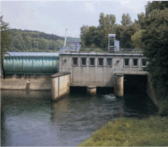
Abb. 3.24: Fischbauchklappe neben einer Wasserkraftanlage
