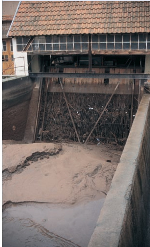
Abb. 7.16: Sandablagerungen im Stauraum vor einem Turbinenrechen (sichtbar nach Absenken des Staus)
