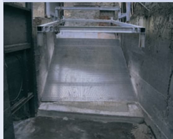
Abb. 12.14: Rechenanlage bei entleertem Oberwasserkanal
