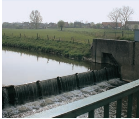
Abb. 3.25: Stahlklappe als Kulturwehr
