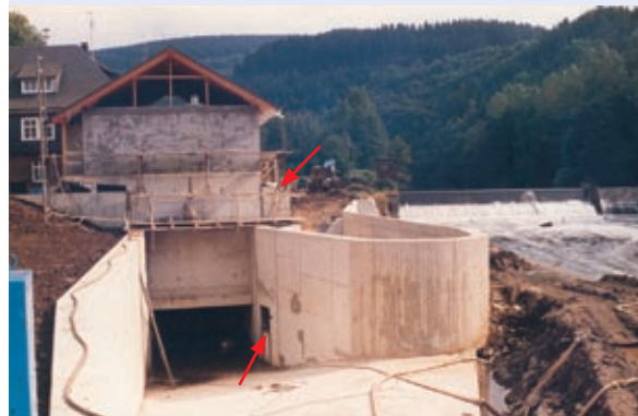
Abb. 10.28: Unterwasserseitige Ansicht einer im Bau befindlichen Wasserkraftanlage an der Sieg (Rheinland-Pfalz, 1985). Rechts ist neben dem Saugrohraustritt der Einstieg in die Fischschleuse erkennbar. Die Schleuse ist parallel zum Krafthaus angeordnet und mündet in den Oberwasserkanal. Funktionskontrollen zu dieser Anlage liegen bisher nicht vor.
