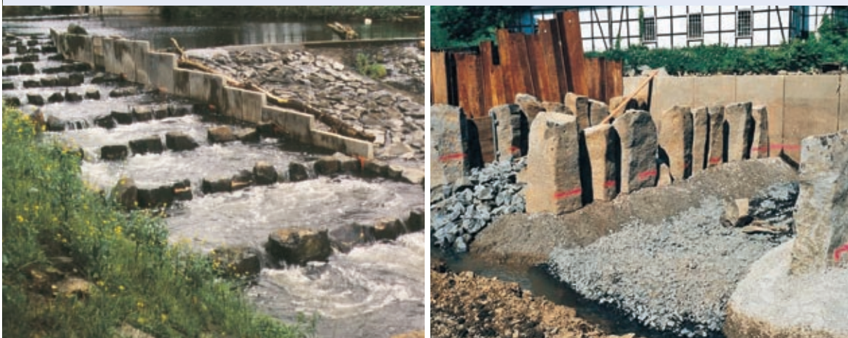
Abb. 10.43: Raugerinne-Beckenpass Betzdorf (Sieg) im Betrieb ( Q=500 \text{ l/s} ), rechts im Bau. Auch hier wurde der unterwasserseitige Einstieg möglichst nahe an den Wehrfuß gelegt und der Fischpass mit einer Trennwand in Richtung Oberwasser verschoben. Im Bild wird der gesamte Abfluss durch den Fischpass geleitet. Bei höheren Abflüssen wird das Wehr überströmt und der Unterwasserspiegel steigt an, wodurch der Einstiegspunkt in den Fischpass zum Wehrfuß hin verschoben wird.
