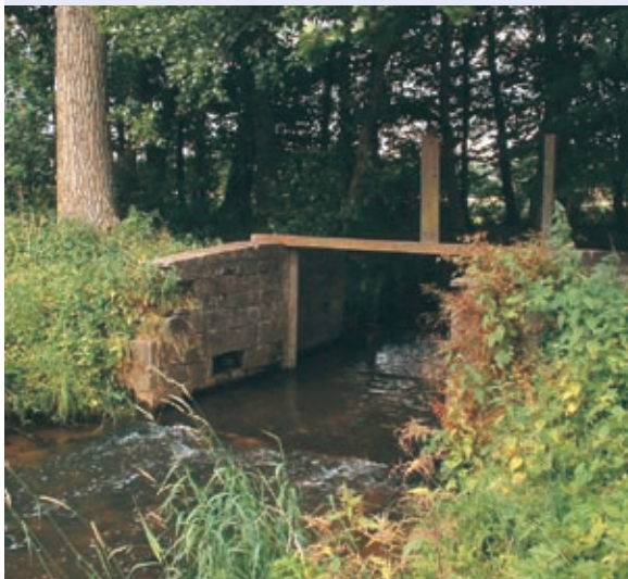
Abb. 3.6: Ehemaliges Schützwehr, das nur noch als Grundschwelle wirkt
