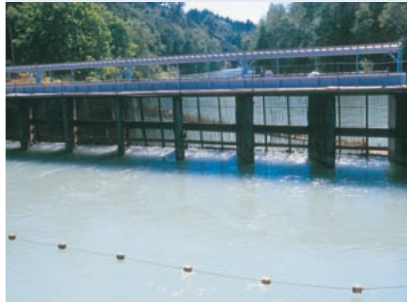
Abb. 12.29: Grobrechen vor der mechanischen Barriere in Abb. 12.30
