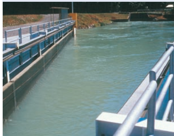
Abb. 12.30: Beidseitig schräg angeordnete mechanische Barriere mit einer lichten Weite von 1,5 mm zum Schutz pazifischer Lachssmolts (USA). Die Anlage ist im Oberwasserkanal eines Wasserkraftwerks eingebaut, Ausbaudurchfluss: 15 m 3 /s. Der Bypass befindet sich mittig am Ende der Rechenfelder.
