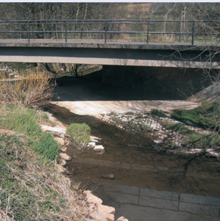
Abb. 8.17: Strukturell überformte und minimal durchflossene Ausleitungsstrecken sind Wanderhindernisse und massiv geschädigte Lebensräume
