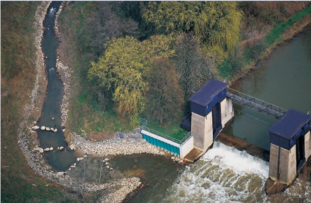
Abb. 10.45: Luftaufnahme Wehr Beckinghausen/Lippe mit Fischaufstiegsanlage bei höherer Wasserführung als in Abb. 10.33. Der Fischpass ist im Bereich des Einstiegs so gewandelt, dass die Ausströmung parallel zur Lippe erfolgt.
